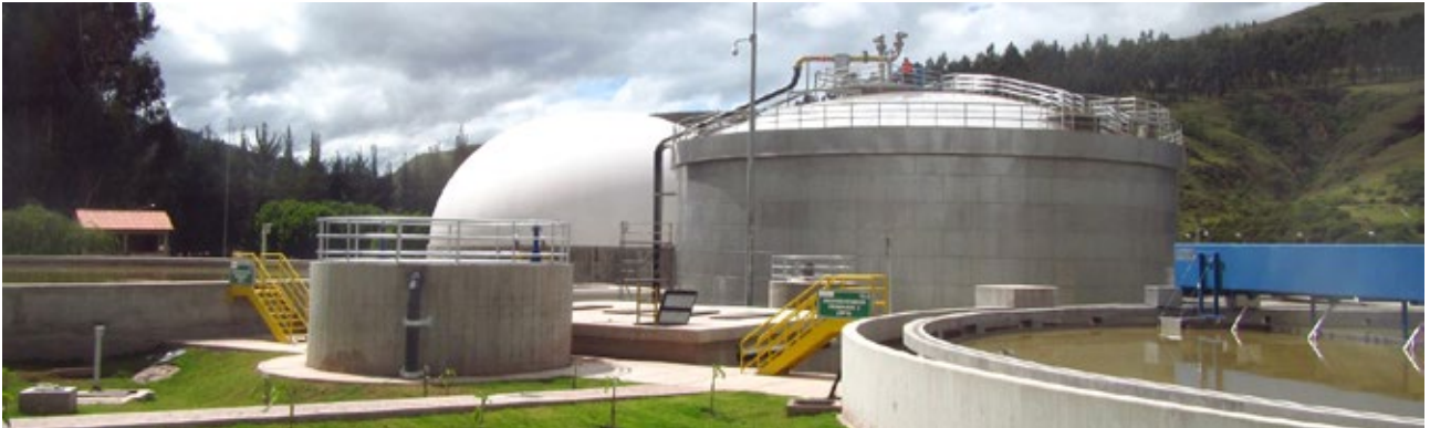
Digestor anaerobio para el tratamiento de lodos municipales © GIZ/Dirk Loose
