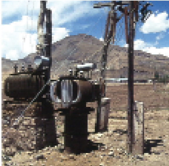
Mauvais exemple d'une station de transformation
