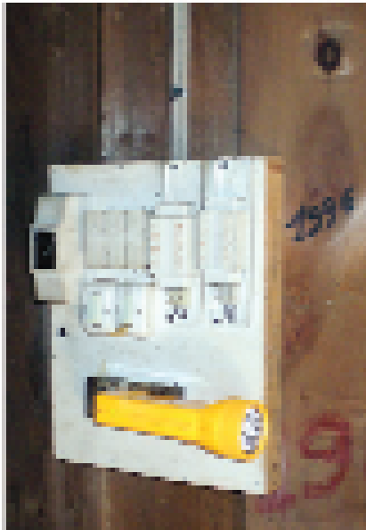
Câblage de maison et connexion - bon
