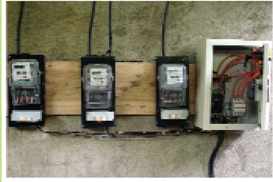
Bonne installation des compteurs
