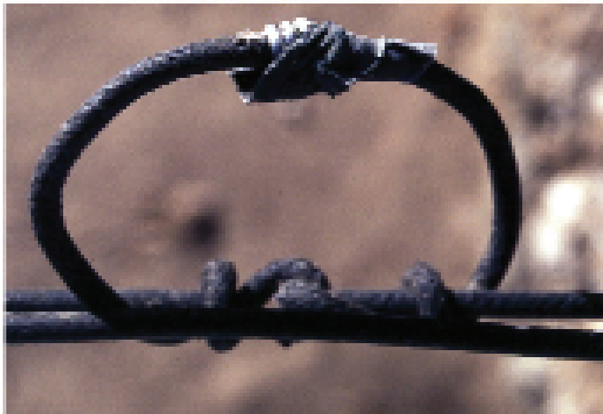
Mauvaise connexion de câbles
