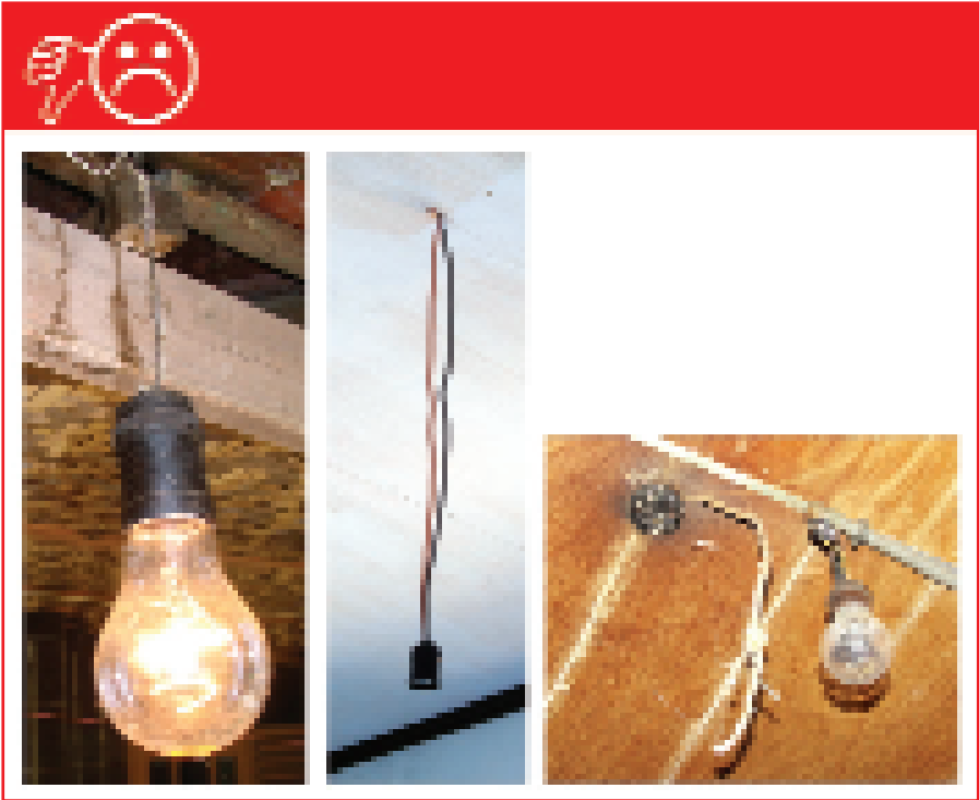
Installations de lampes - mauvais
