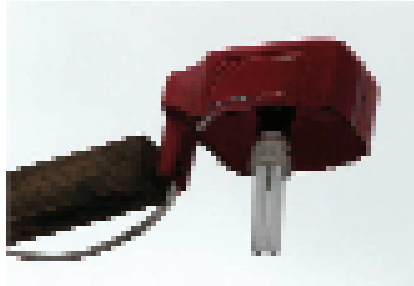
Bons exemples des installations pour l'éclairage public
