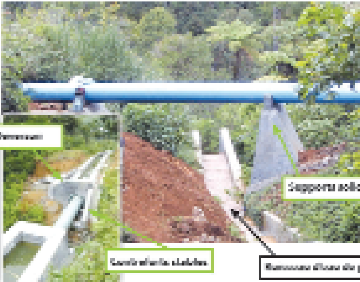
Tuyaux traversants bien construits
