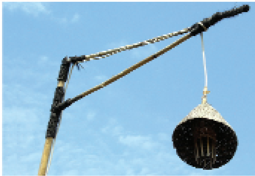
Mauvais exemple d'un câblage d'un réverbère
