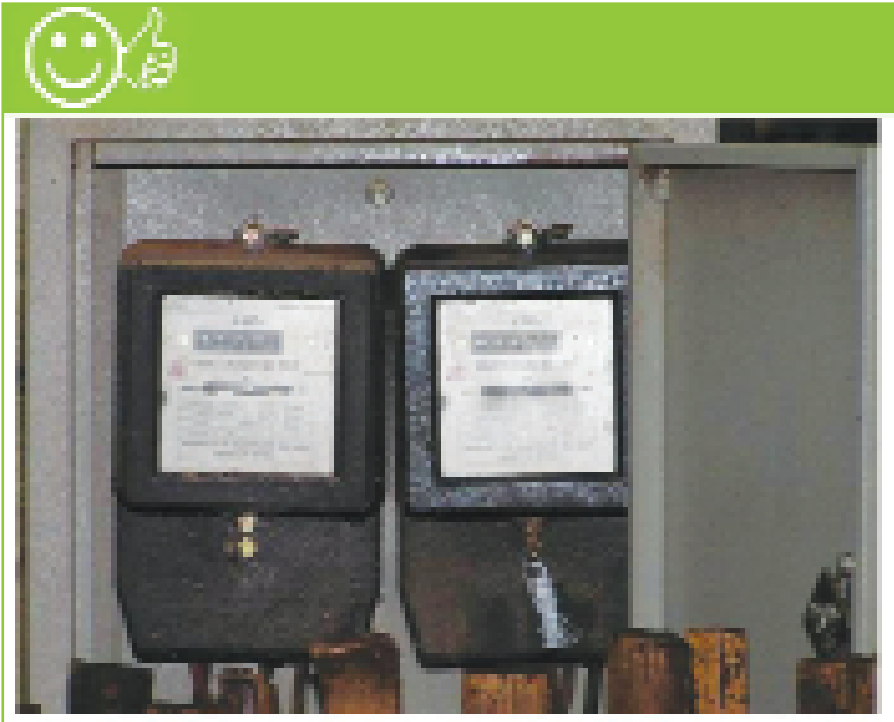
Bonne installation des compteurs
