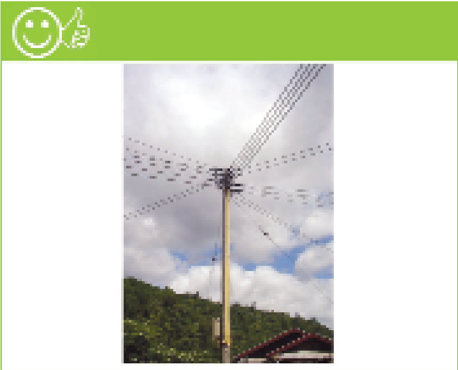
Bon exemple de poteaux & lignes de distribution
