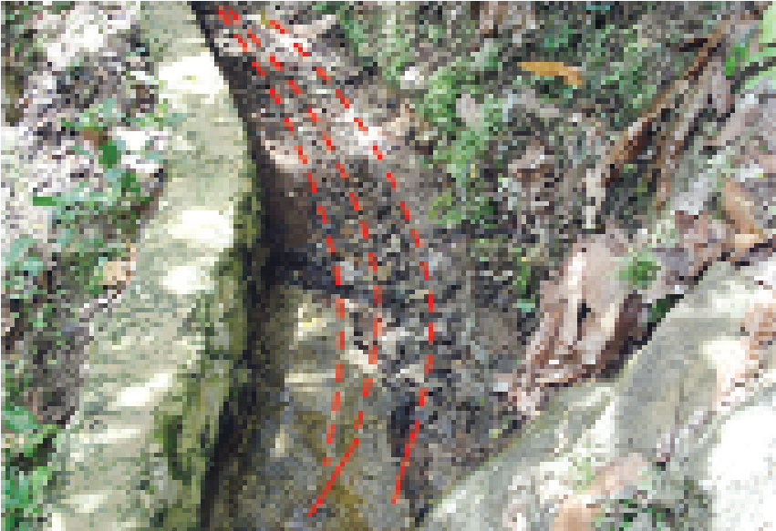
Lit de canal cassé suite à une érosion et un glissement
