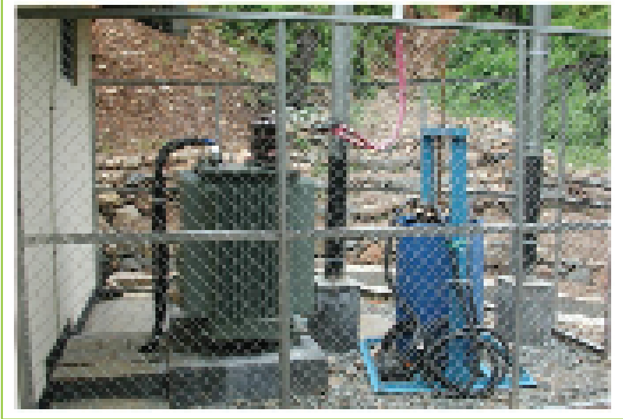
Bon exemple d'une station de transformation
