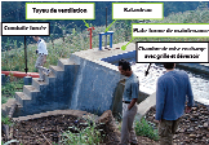
Batardeau de la conduite forcée et tuyau de ventilation
