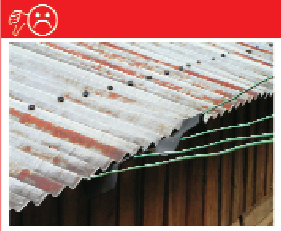
Branchement de maison - mauvais
