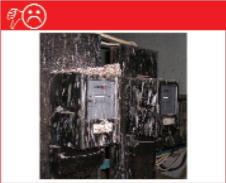
Mauvaise installation des compteurs
