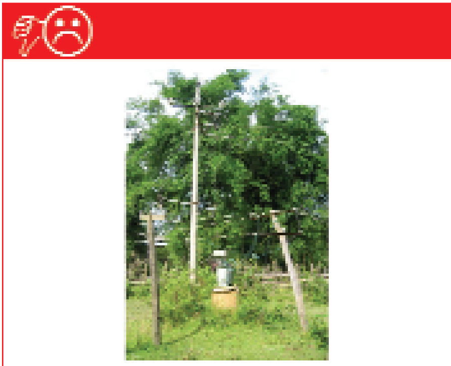
Mauvais exemple de poteaux & lignes de distribution
