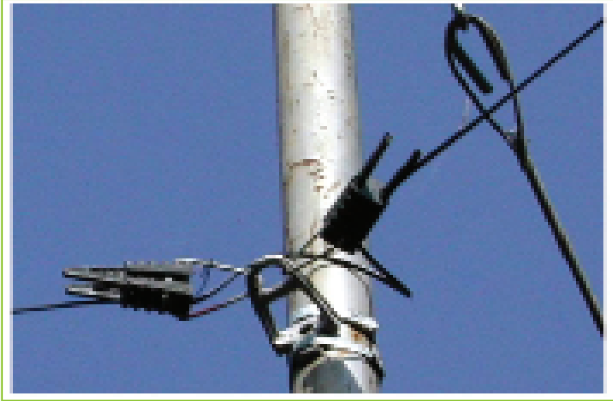
Bon exemple d'une connexion de câbles
