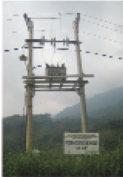
Bon exemple d'une station de transformation
