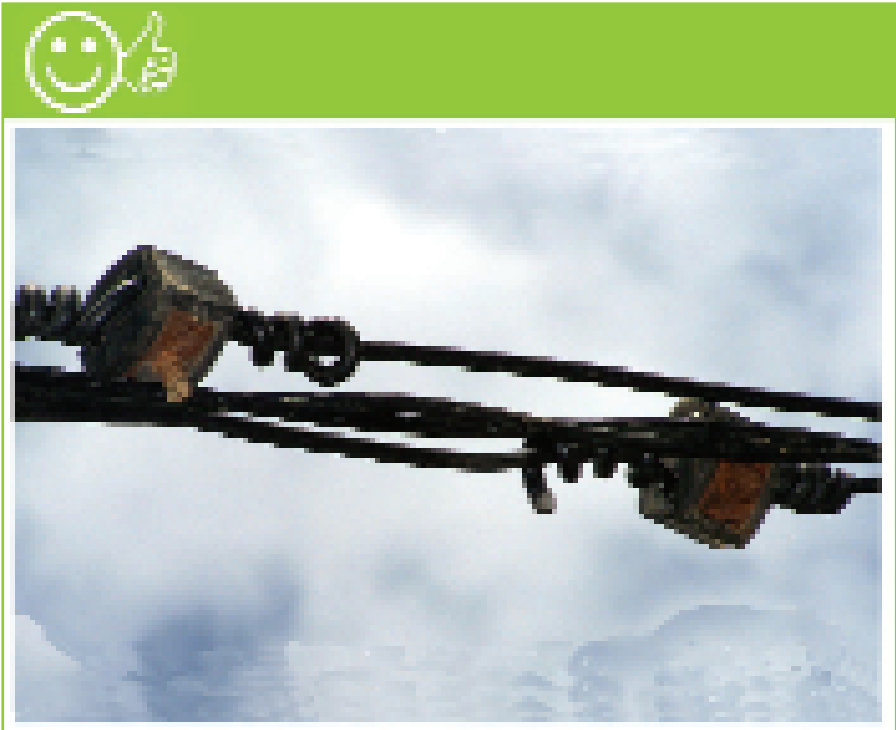
Bonne connexion de câbles
