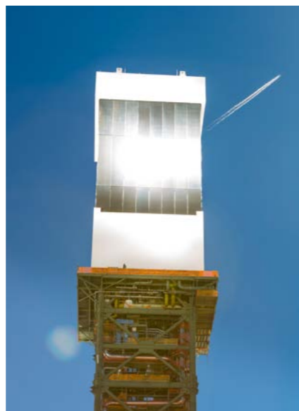
Figure 44 : Récepteur central (chaudière)
