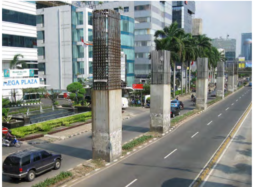
Hình 1: Công trình đường sắt ray đơn bị bỏ hoang khi đang thi công dở dang do thiếu nguồn đầu tư tài chính.
