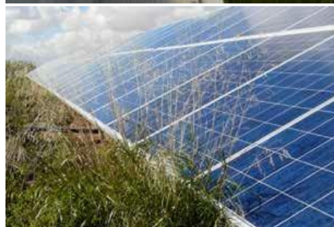
Exemple d'une connexion par câble dangereuse ; corrosion galvanique d'un système de suiveur
