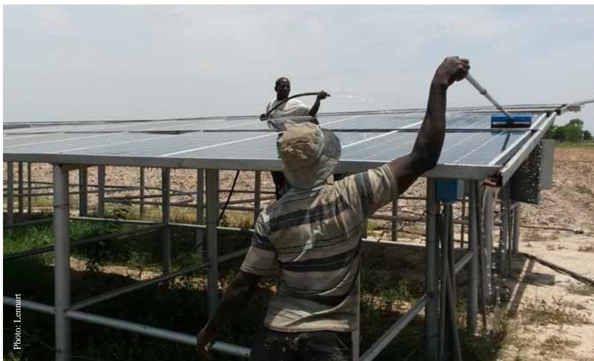
Nettoyage de panneaux solaires au Ghana dans le cadre de l'entretien courant
