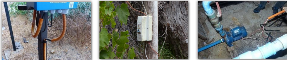
Figura 16: Ejemplos de aspectos de instalaciones eléctricas que deben ser mejorados Fuente: Elaboración propia en base a trabajo de terreno
