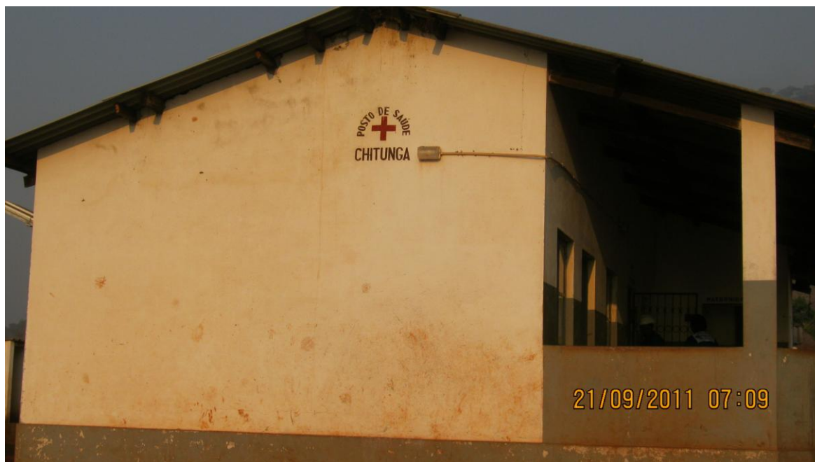
Posto de saude de Chitunga beneficiario de energia fotovoltaica
