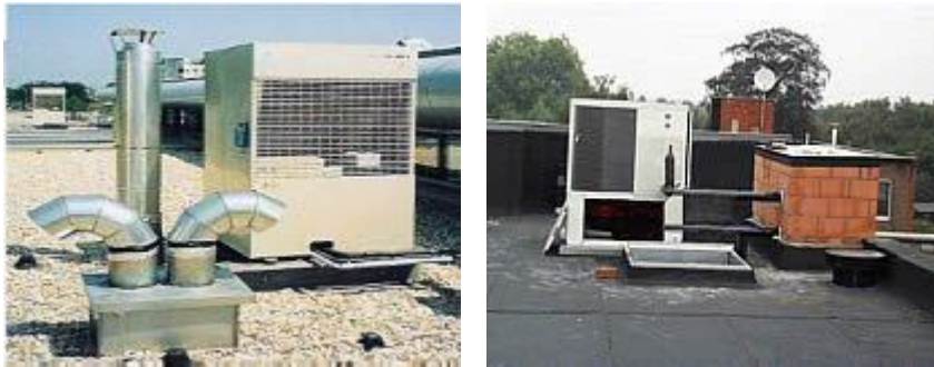
Figura 142 Ubicación de condensador
