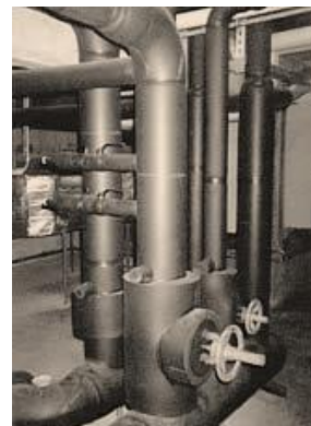
Figura 141 Aislamiento de tubería de agua helada
