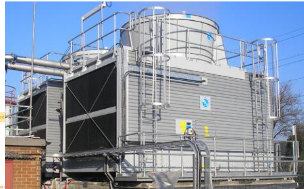
Figura 124 Torre de refrigeración BAC modelo S3000E
