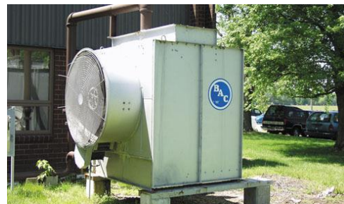
Figura 122 Torre de refrigeración BAC modelo FXT
