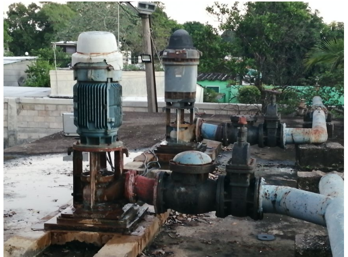
Foto 5. Equipos de la Planta potabilizadora de Frontera
