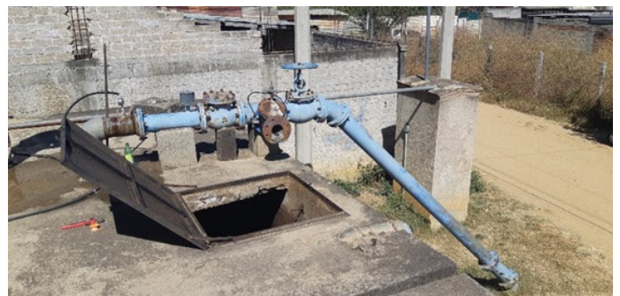
Foto 2. Cárcamo de rebombeo
