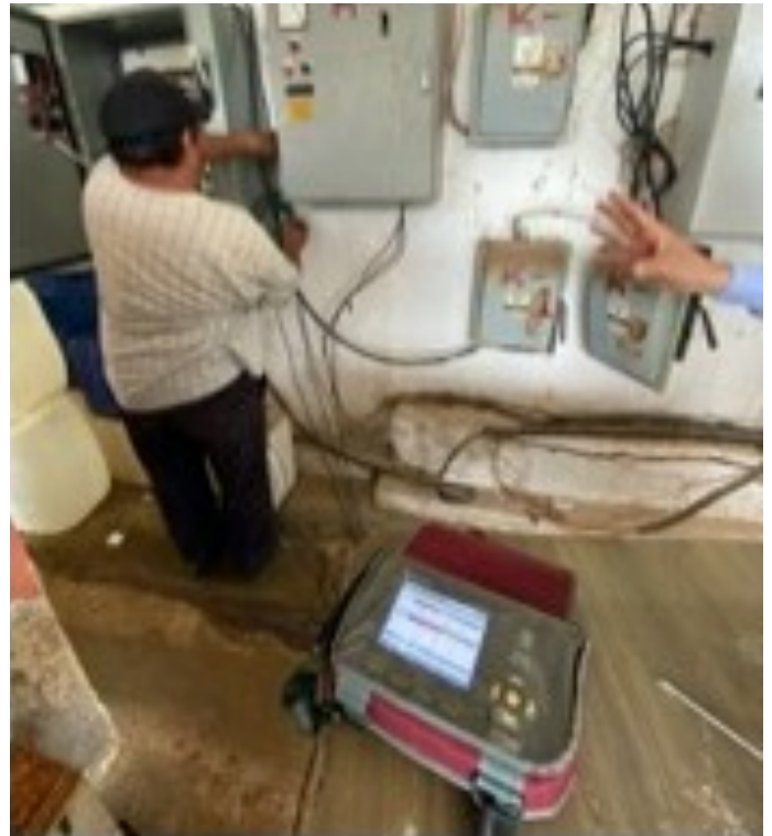
Foto 9. Medición de parámetros eléctricos en la Planta de la 54A, Tizimín, Yucatán
