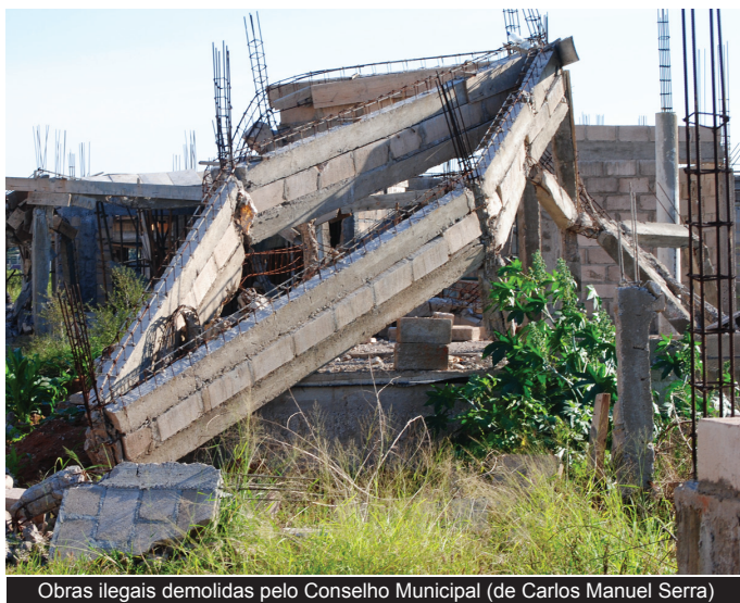
Obras ilegais demolidas pelo Conselho Municipal (de Carlos Manuel Serra)
