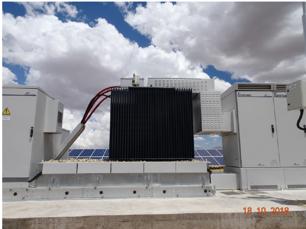
Figura 17: Estación de inversor (2)
