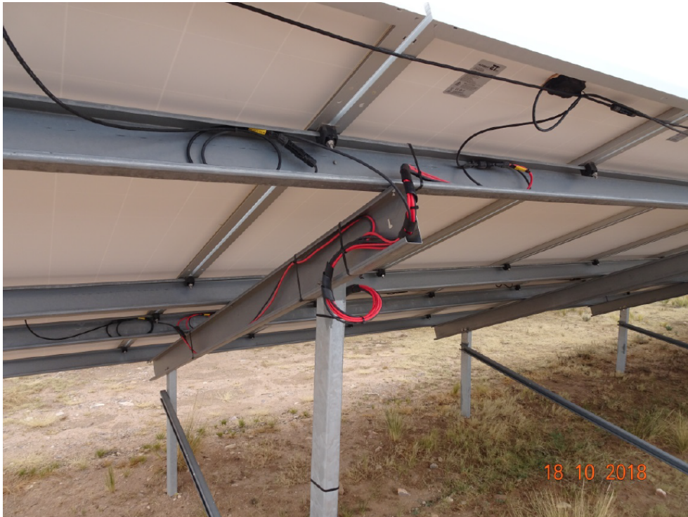
Figura 12: Módulos y cables vista posterior
