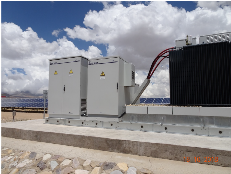
Figura 16: Estación de inversor (1)
