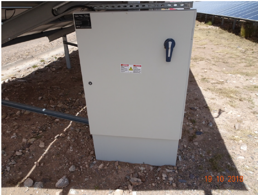
Figura 14: Caja de conexiones CC
