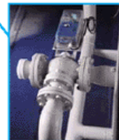
Régulation modulante du débit
