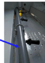
Tuyauterie d'injection de bassin
