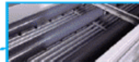
Rampes de distribution d'eau
