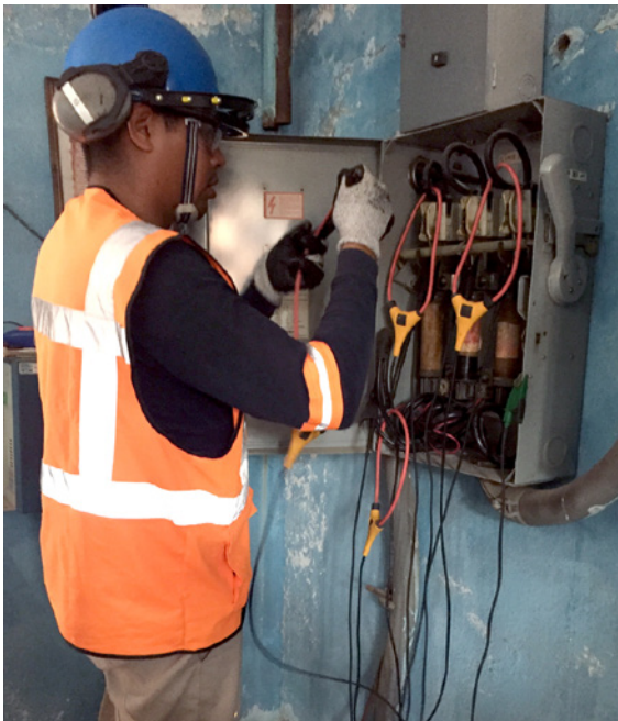
FIGURA 19. Capacitación. ECo318: Mantenimiento Electro-mecánico de una Estación de Bombeo de Agua Potable
