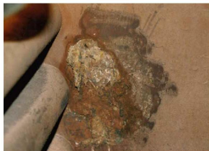
Corrosion oxygène localisée
