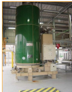
Economiseur sur chaudière à production instantanée
