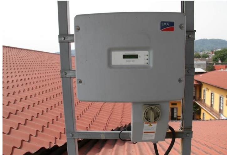
Figura 14: Ejemplo de una mala instalación – Falta de interruptor corriente directa
