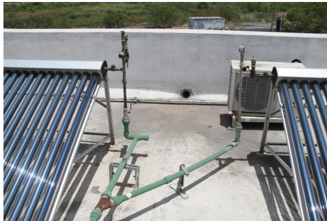
Figura 3: Ejemplo de una buena instalación en válvulas de corte
