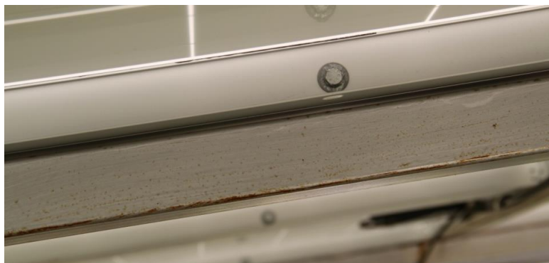
Figura 17: Ejemplo de una mala instalación – Marco del panel perforado
