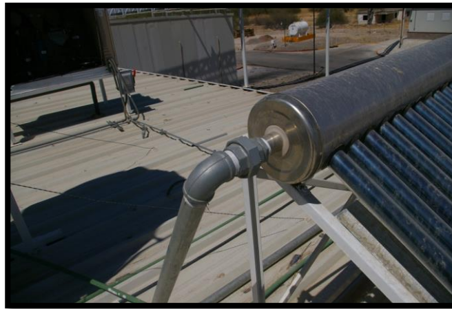
Figura 6: Ejemplo de una instalación sin aislante en tubería de agua caliente
