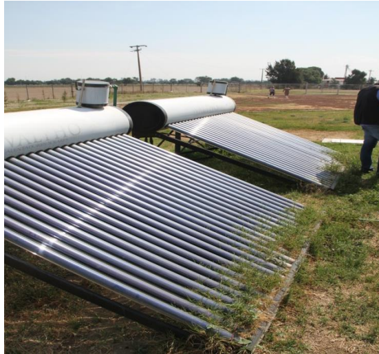
Figura 9: Ejemplo de una mala instalación – Plantas en la instalación
