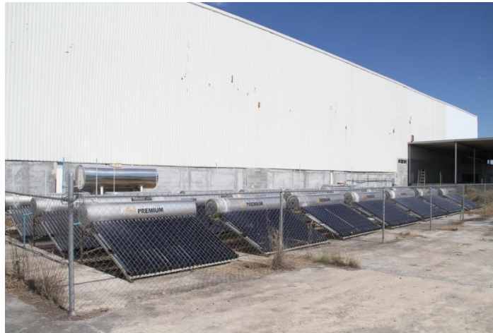
Figura 7: Ejemplo de una mala instalación – Muchos termo-tanques individuales
