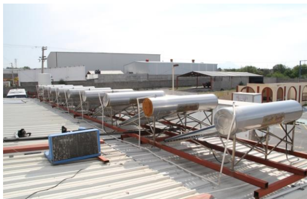
Figura 8: Ejemplo de una mala instalación – Distancia entre colectores
