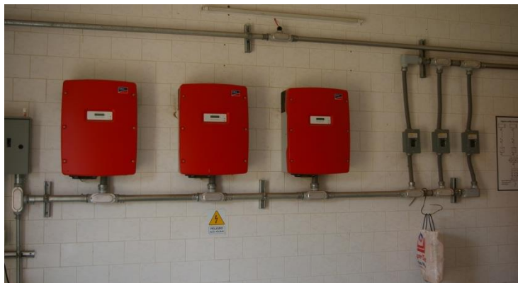
Figura 15: Ejemplo de una buena instalación –Interruptor corriente directa adecuado
