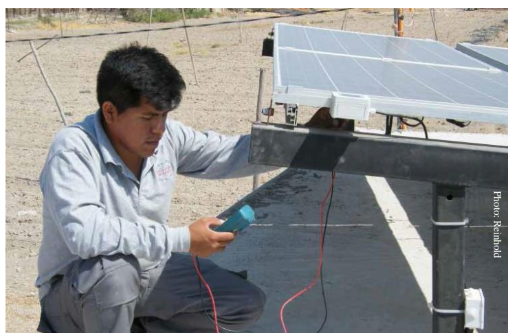
Midiendo la irradiación solar durante la prueba de aceptación in situ
