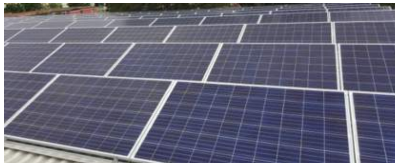
Ilustración 3 Ejemplo módulos en un sistema FV, Teletón Santiago (Fuente: Ministerio de Energía)
