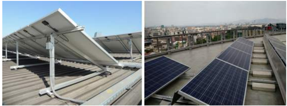
Ilustración 5 Estructura de soporte de módulos fotovoltaicos inclinados. Izquierda: Planta Fotovoltaica Edificio GAM. Derecha: Planta Fotovoltaica lastrada en Ministerio de Energía (Fuente: Ministerio de Energía)
