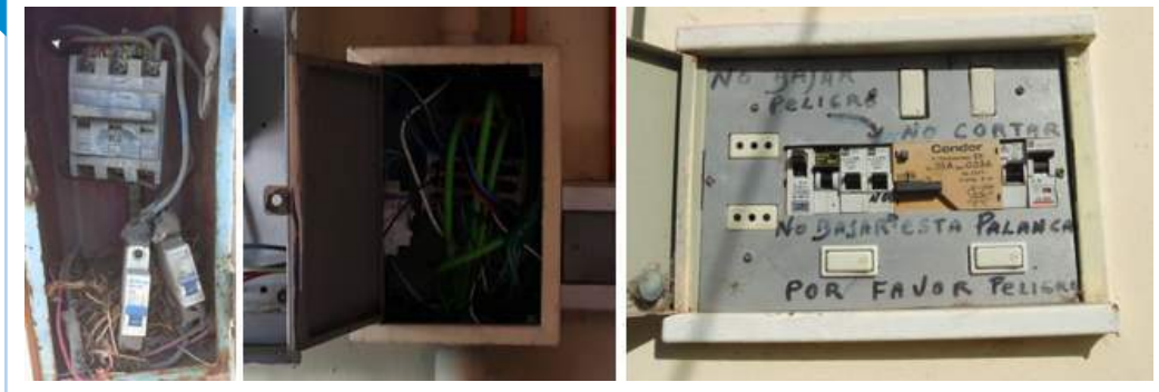
Ilustración 24 Izquierda y Centro: Tableros desordenados y con cables con cobre a la vista, Derecha: Tablero con enchufes e interruptores
