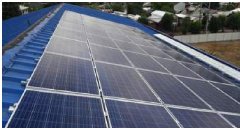
Ilustración 6 Estructura de soporte de módulos FV paralelos al techo (Fuente: Ministerio de Energía)
