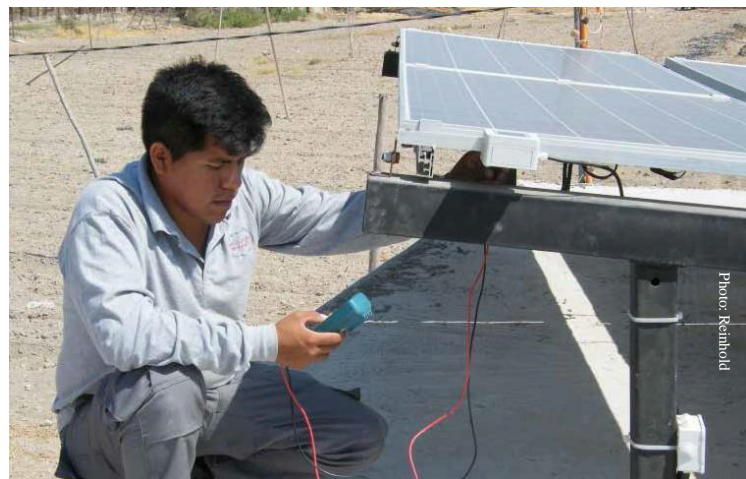
Midiendo la irradiación solar durante la prueba de aceptación in situ
