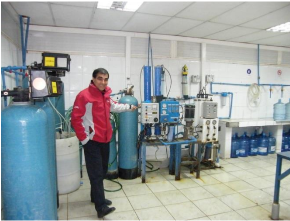
Ilustración 3: Planta de osmosis inversa.
