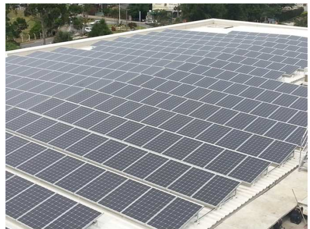
Projeto Megawatt Solar des Energieversorgers Eletrosul – mit 1 MWp leistungsstärkste dachintegrierte PV-Anlage im Süden Brasiliens (Quelle: Eletrosul)
