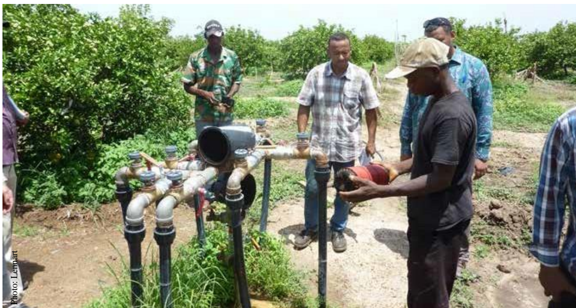
Cabezal de riego con filtro de disco y múltiples válvulas que guían el agua a diferentes secciones del sistema de riego
