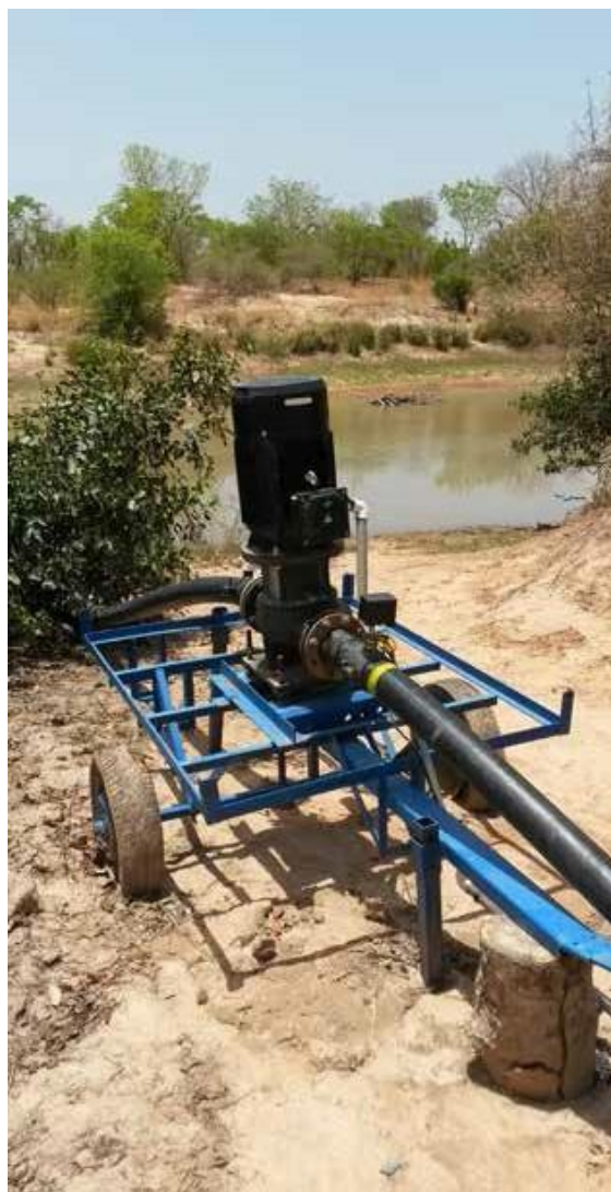
Bomba de superficie montada sobre una estructura móvil
