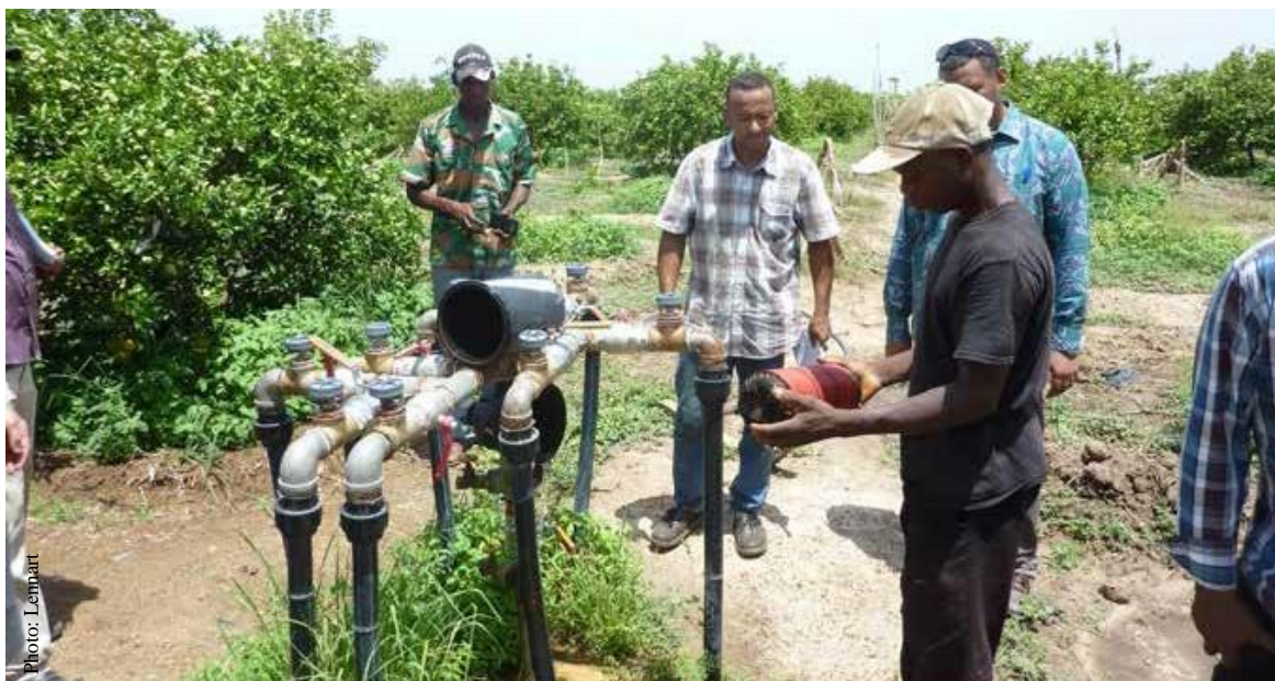
Cabezal de riego con filtro de disco y múltiples válvulas que guían el agua a diferentes secciones del sistema de riego
