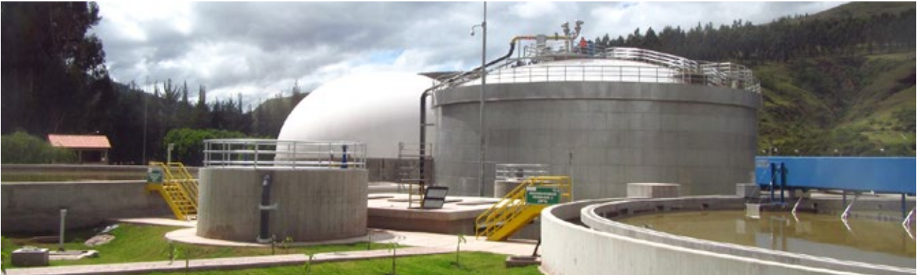
Digestor anaeróbico para tratamento de lodo municipal © GIZ/Dirk Loose
