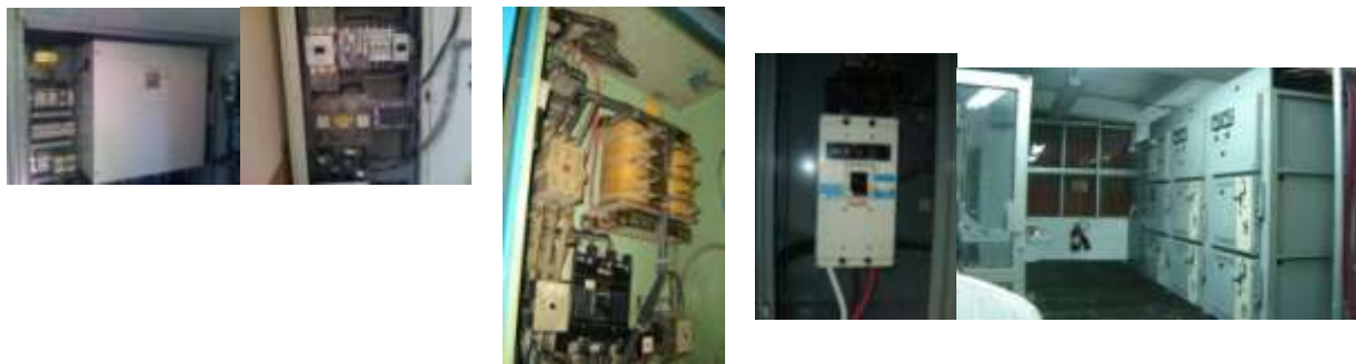
Figura 20. Componentes típicos del sistema electromotriz de un sistema de bombeo
