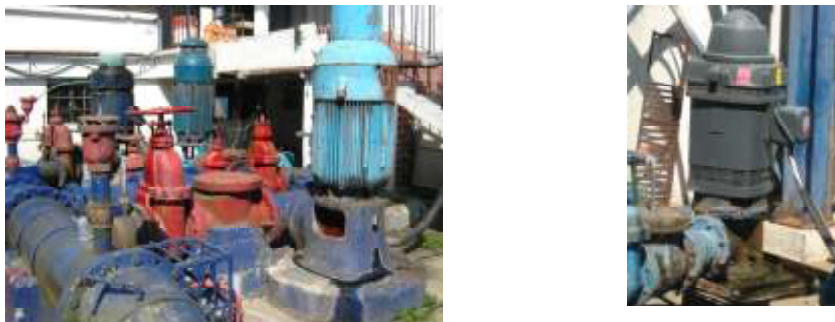
Figura 24. Problemas típicos de falta de mantenimiento en equipos de bombeo
