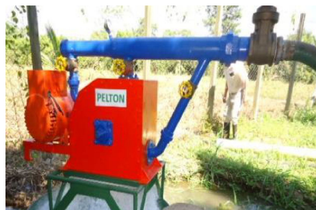
Fotografía 10: Turbina tipo Pelton
