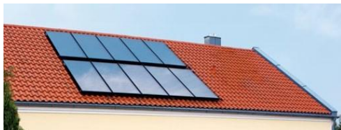
Kolektorë me pllaka të sheshta të instaluar në çatinë e një ndërtese banimi
