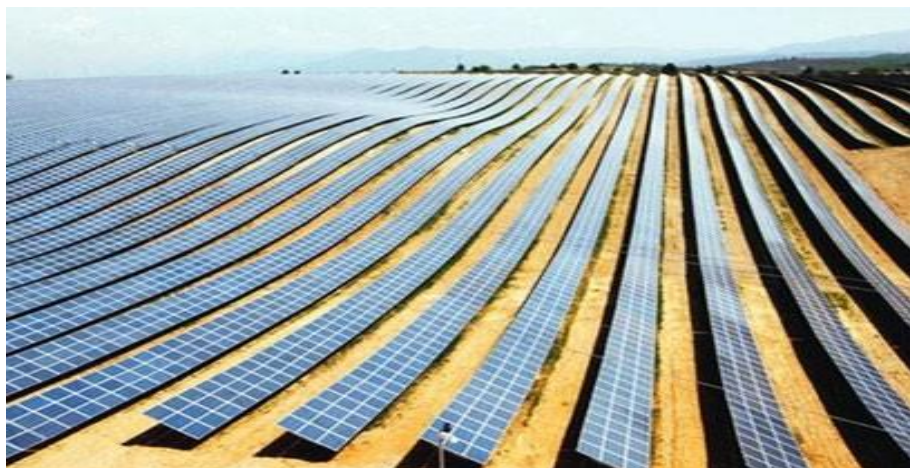
Matricë qelizash fotovoltaike
