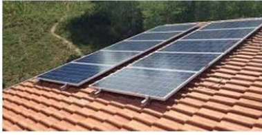
Panele diellore në çatitë e ndërtesave të banimit
