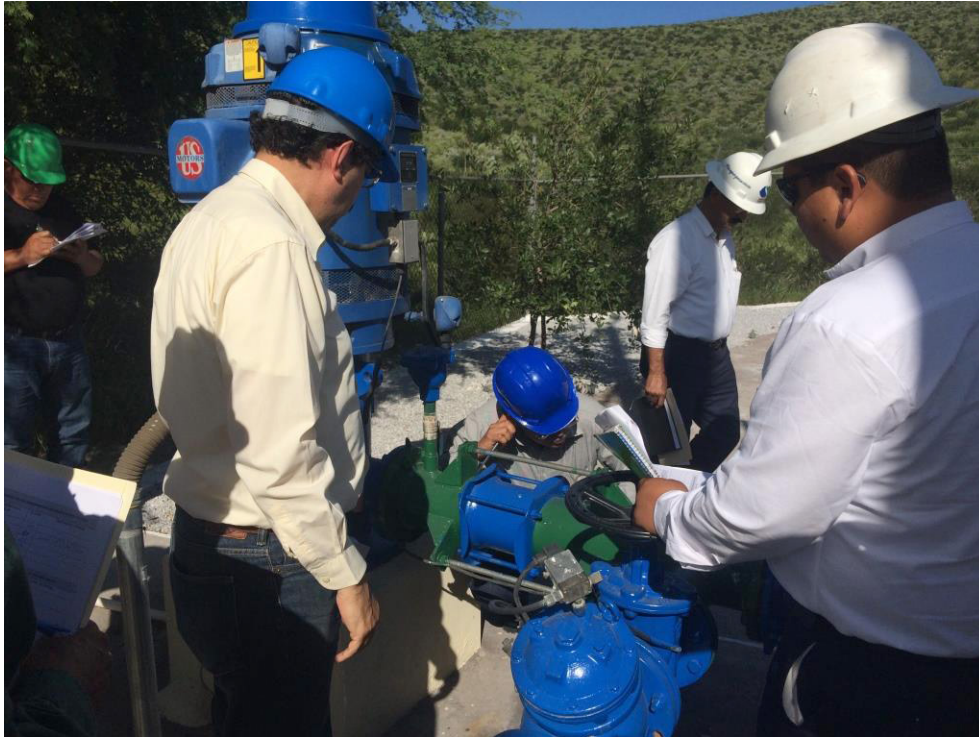
FIGURA 12. Capacitación EC0319: Vigilancia de la Operación en una Estación de Bombeo de Agua Potable
