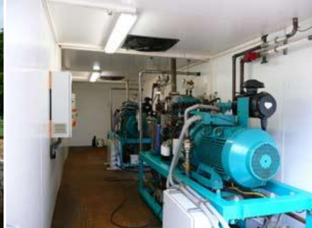
Abbildung 2: Technikcontainer mit BHKW der Biogasanlage in Kilifi; © GTZ/Kilifi Plantations Ltd.
