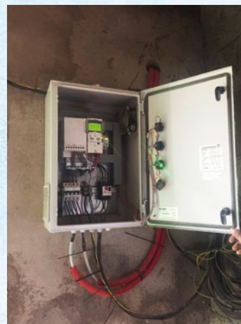
Photo 14 Unité de contrôle du système
