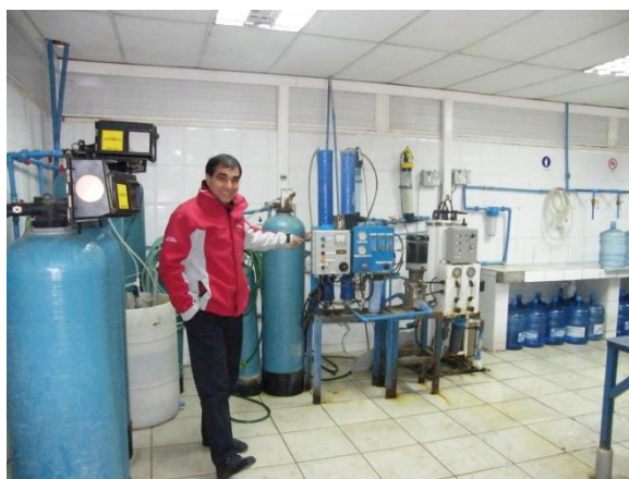
Ilustración 3: Planta de osmosis inversa.
