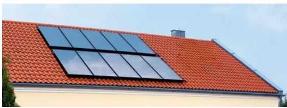
Рамни колектори инсталирани на покривот на станбена зграда
