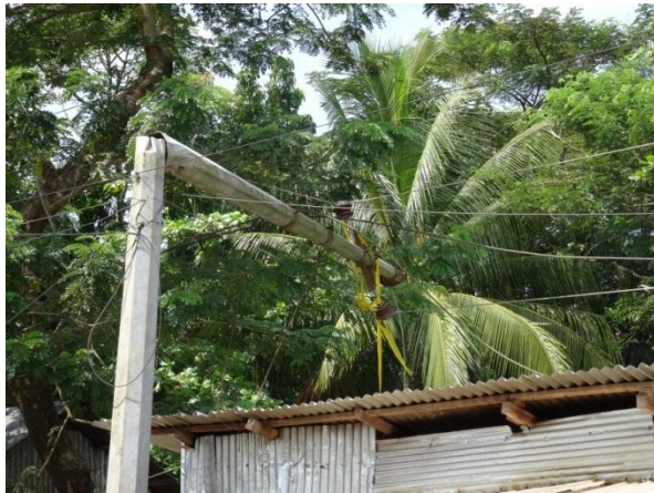
Broken power pole – Hatiya Island Bangladesh (Bertheau, 2014).
