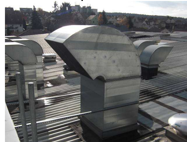
Système de ventilation
