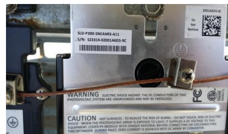
Imagen 17 Conexión a tierra con cable desnudo.
