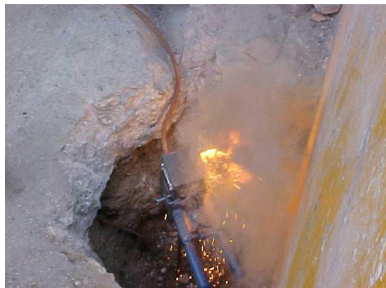
Imagen 22 Conexión de conductor de tierra física unido a electrodo con soldadura exotérmica.
