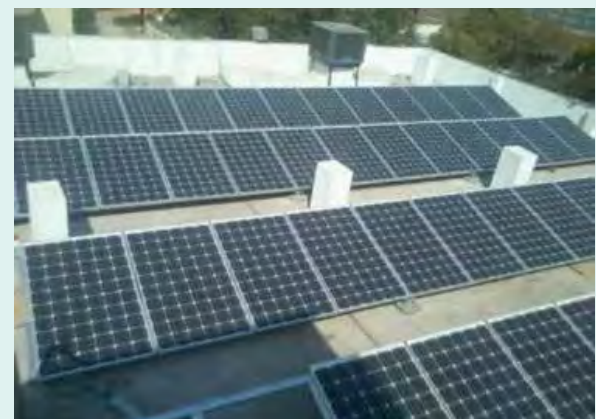
E.I Dupont 25 KW solar plant.
