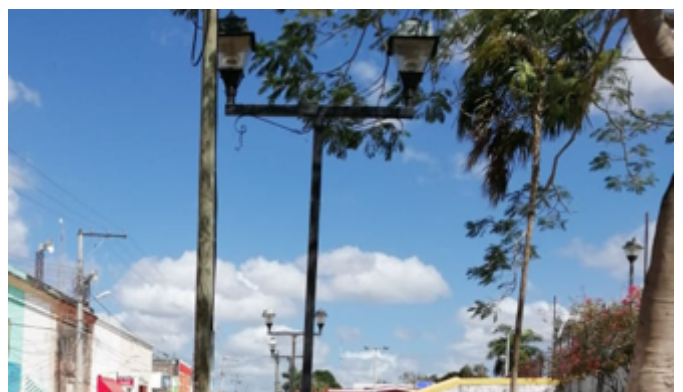
Imagen 4. Diagnóstico energético al sistema de alumbrado público
