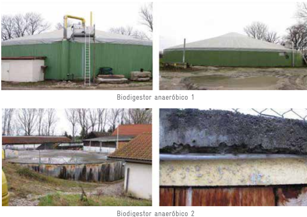
GRÁFICO 3.25. Biodigestores anaeróbicos con desulfuración interna por microaireación
