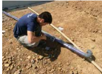
l) Instalación del medidor del nivel de llenado del gasómetro.
