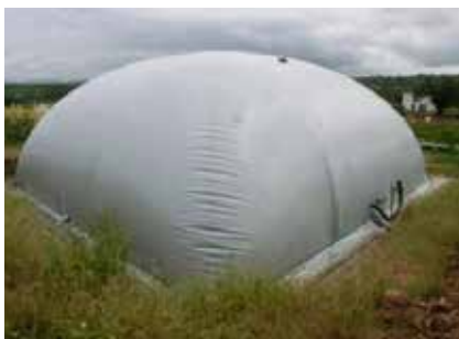
m) Gasómetro instalado.
