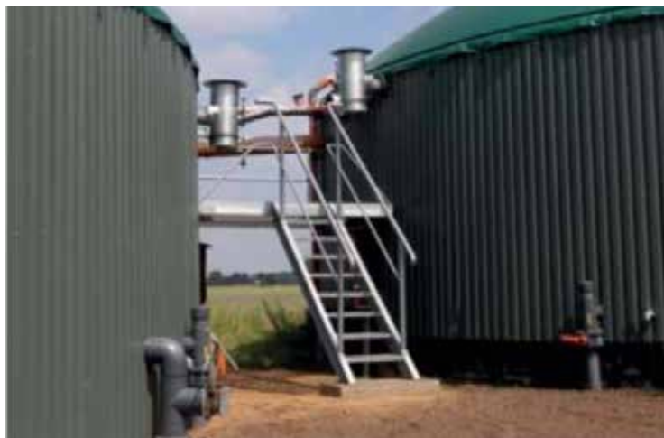
GRÁFICO 3.17. Plataforma de trabajo entre dos tanques y dispositivos de alivio de presión en la empresa MT-ENERGIE GMBH
