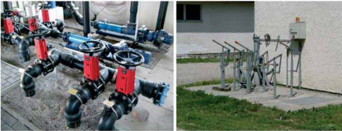
GRÁFICO 3.16. Tuberías, válvulas y accesorios de seguridad de la estación de bombeo, y válvulas de cierre en la empresa DBFZ Deutsches Biomasseforschungszentrum
