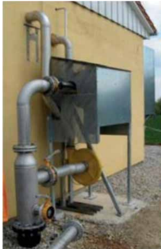
GRÁFICO 3.18. Tubería de gas con compresor de aire en la empresa DBFZ Deutsches Biomasseforschungszentrum
