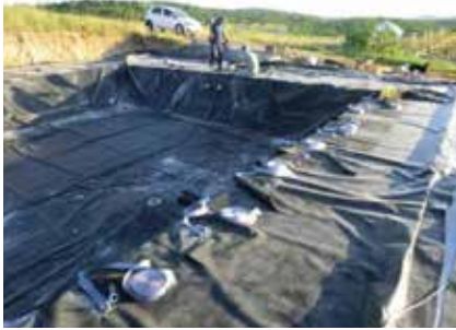
a) Instalación de geomembrana y de sistema de fijación de la red de nylon.
