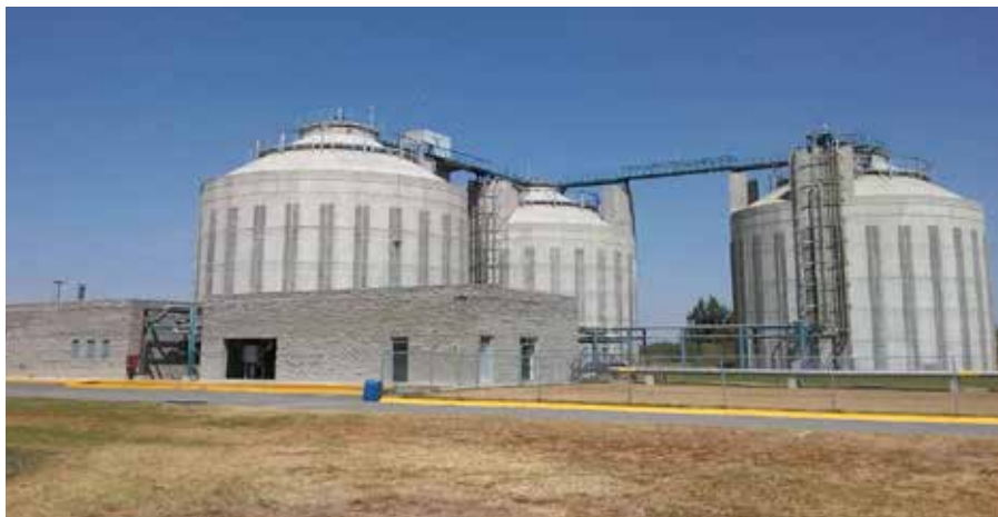
GRÁFICO 4.16. Biodigestores anaeróbicos de la PTAR municipal
