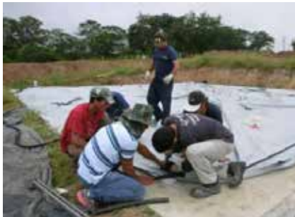
k) Instalación de la manguera presurizada para fijación de las tres capas: PEAD, membrana interna y membrana externa.
