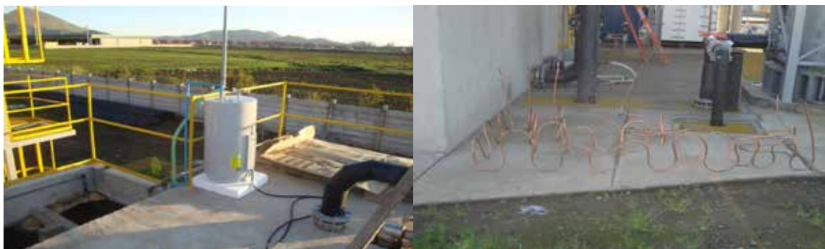
GRÁFICO 4.13. Calentador de gas y serpentín de cobre que recibe el agua caliente que este genera
