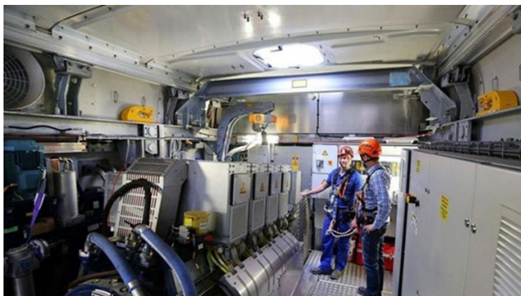
Unutrašnjost gondole vetroturbine
