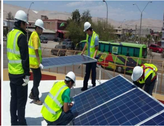
Sistema Fotovoltaico Práctico, con dos tipos de tecnologías: inversor central y microinversores
