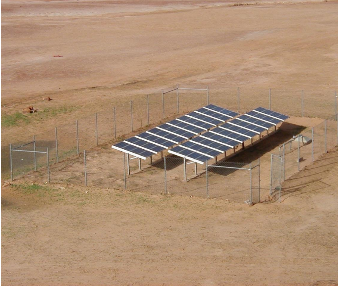
Pompage avec stockage tampon – crédit photo : Hubert Bonneviot
