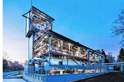
Foto: Central Termoeléctrica susceptible de ser reconvertida. Gentileza DLR.
