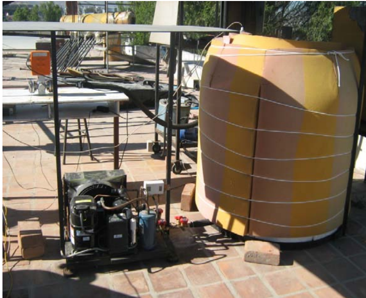
Figura 5.3 Fotografía del sistema de refrigeracion
