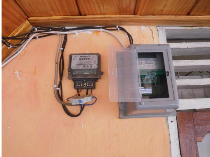
Gambar 24 Pembatas energy di rumah penerima listrik dari PLTS di Lamdesar Barat, Pulau Larat
