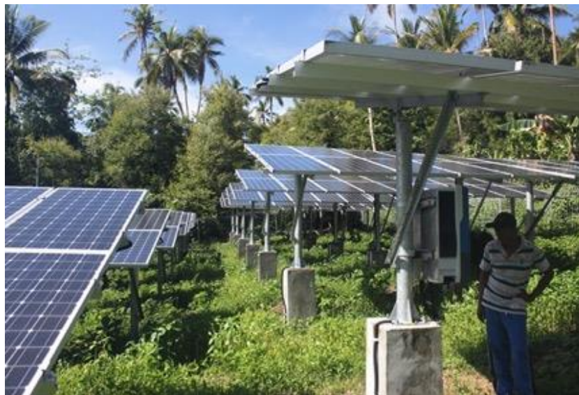
Gambar 14 PLTS berkapasitas 50 kWp di Pulau Kawaluso
