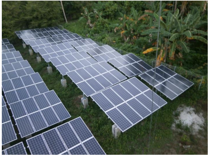
Gambar 2 PLTS Kawaluso berkapsitas 50 kWp melistriki 153 KK
