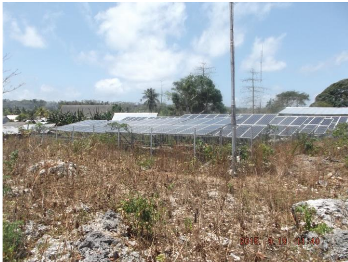
Gambar 19 PLTS berkapasitas 50 kWp di Pulau Larat
