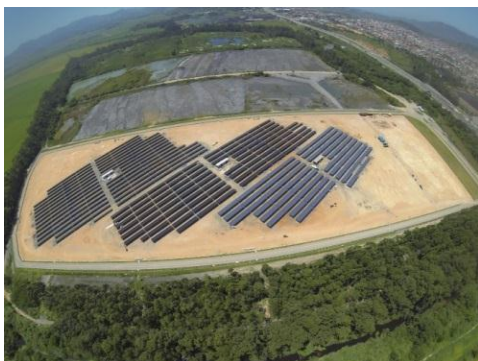
Kommerzielle Anlagen folgen den F+E-Projekten – hier PV-Anlage in Tubarão (SC)
