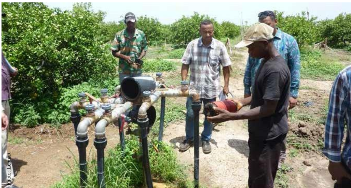
Cabezal de riego con filtro de disco y múltiples válvulas que guían el agua a diferentes secciones del sistema de riego
