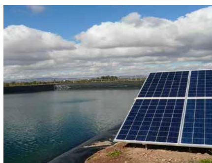
Reservorio de agua abierto impermeabilizado con lámina de plástico
