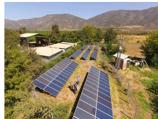
Foto: Planta solar fotovoltaica en Chile
