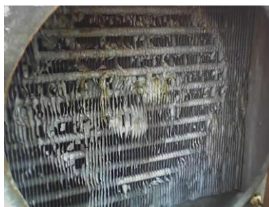
Figura 70 Aletas en mal estado
