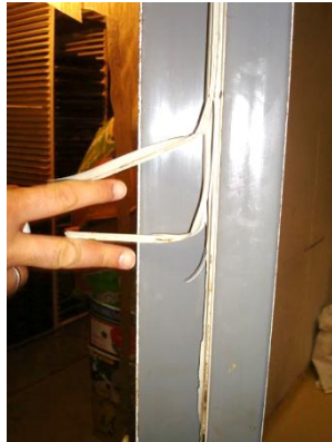
Figura 74 Sello en mal estado de la puerta de una cámara de refrigeración
