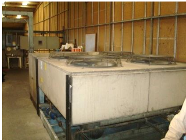
Figura 68 Condensador mal ubicado
