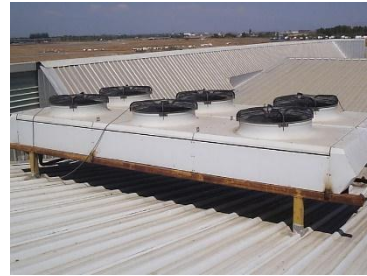
Figura 69 Condensador bien ubicado
