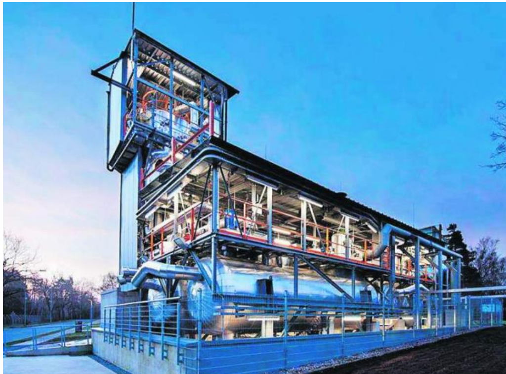
Foto: Central Termoeléctrica susceptible de ser reconvertida. Gentileza DLR
