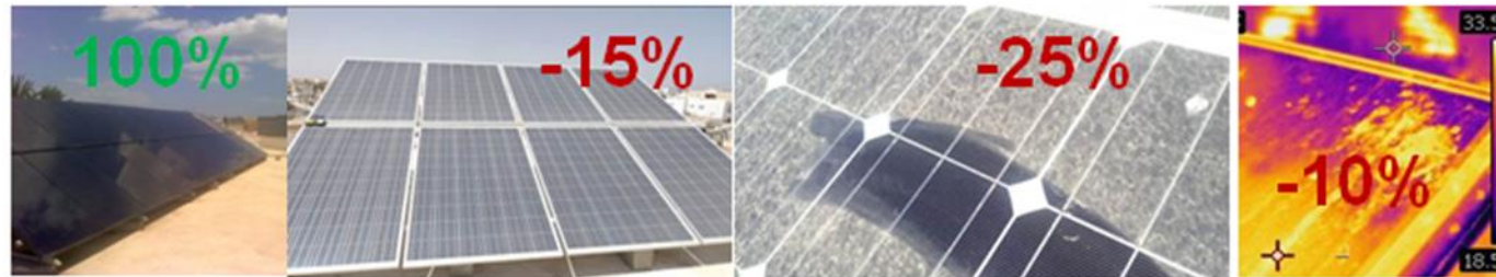
FIGURE 27 : EXEMPLES D'ENCRASSEMENT ET DE PERTES DE PUISSANCES ASSOCIEES
