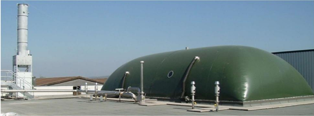
Figura 69: Gasómetro de doble membrana con antorcha en el techo del fermentador (ejemplo).
