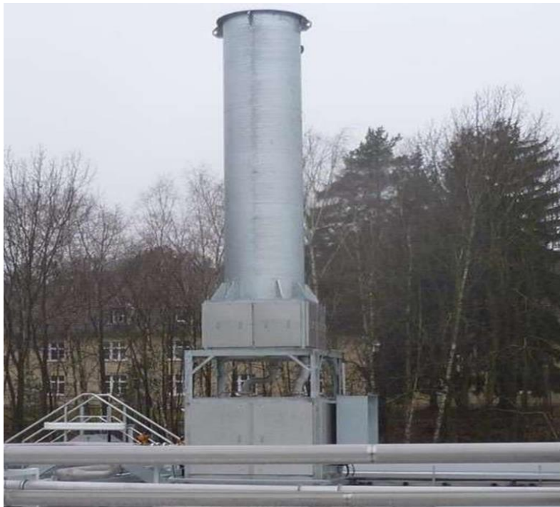
Figura 70: Antorcha de gas pobre y de emergencia de biogás (ejemplo).
