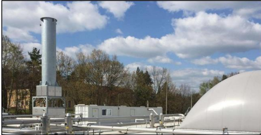
Figura 68: Techo del fermentador con contenedores técnicos, gasómetro y antorcha.
